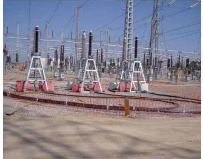
Aplicación típica de enlaces temporales para mantenimiento en subestaciones
